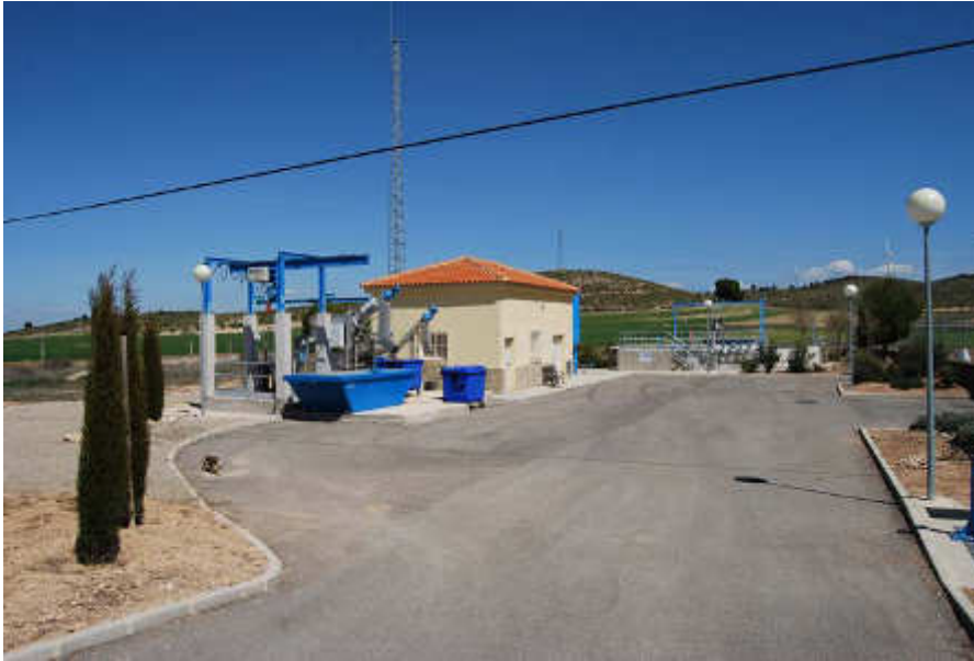
Estación de Depuración de Aguas Residuales (EDAR) municipal
